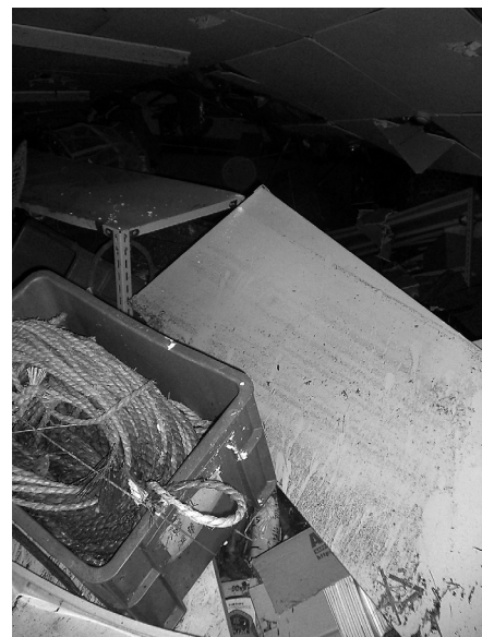
写真2 陸前高田市立博物館二階収蔵庫の被災状況 (2011年4月15日)
